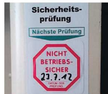
Als nicht betriebssicher eingestuft: Abzüge zum Hantieren mit Chemikalien.
